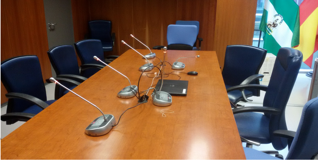
Foto 26: Instalaciones de la sala de vistas del Juzgado de Familia de Málaga
